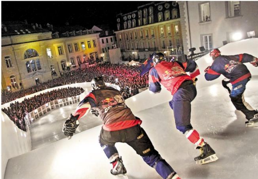
40.000 Zuschauer kamen zum Red Bull Crashed Ice nach Lausanne. Das Reuttener Unternehmen AST hat die Technik für die Wellenbahnen ausgereift und den selektiven Kurs installiert. Foto: AST
